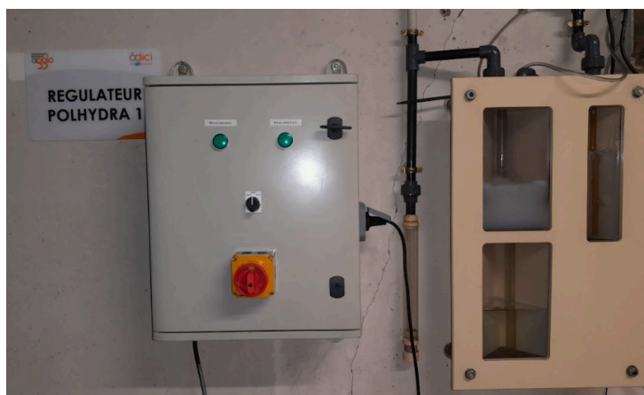
Photos du nouveau coffret de régulation du Polhydra N°1.
