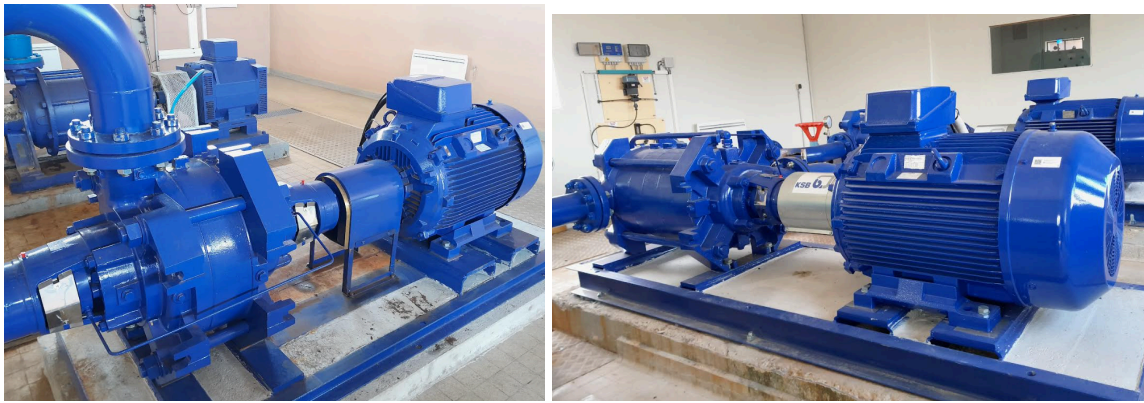
Photos de pompes renouvelées
